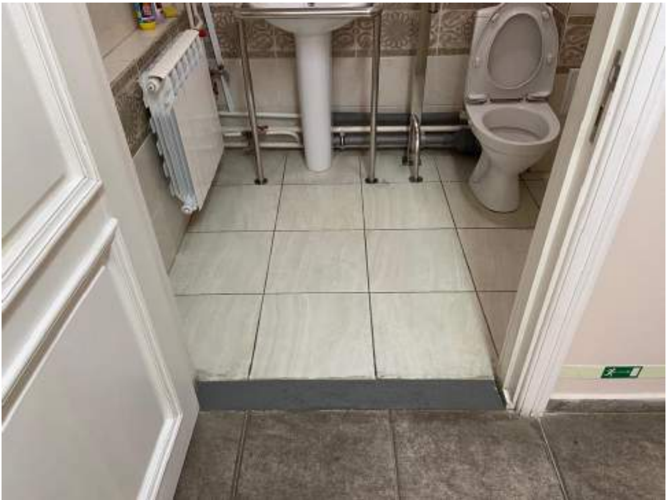
Рисунок 5.6. Отсутствует дверной порог при входе в санузел
